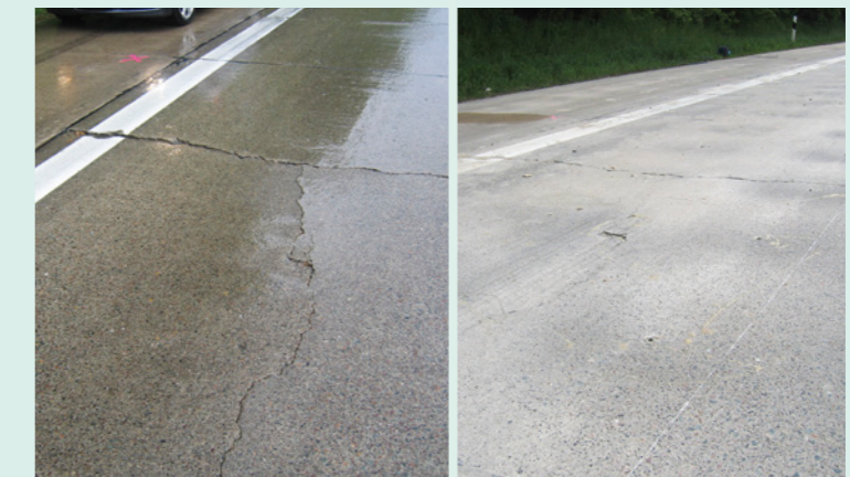
Abgesackte geschädigte Betonplatte vor/nach Sanierung
